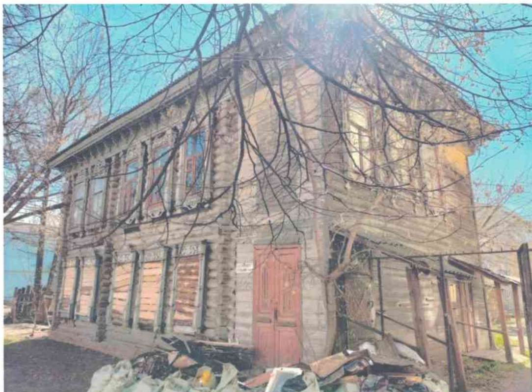
Фото 2. ОКН «Дом с деревянной резьбой». Вид на главный фасад с севера. Отсутствует информационная надпись объекта культурного наследия, отмостка отсутствует, водосточные желоба, трубы и водосборные воронки утрачены.
