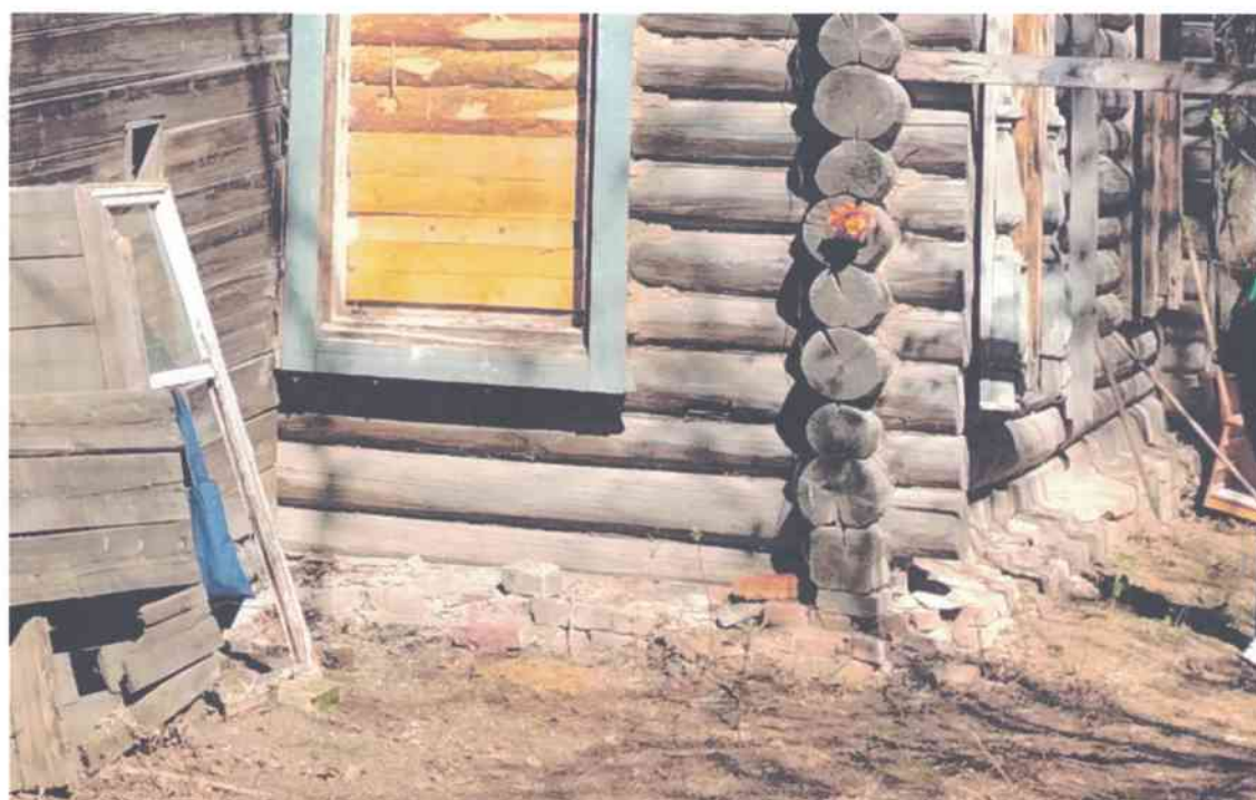
Фото 8. ОКН «Дом с деревянной резьбой». Фрагмент, южный угол объекта. На локальных участках разрушение кирпичной кладки цоколей, роль отлива выполняла стяжка из цементного раствора -разрушена, отмостка отсутствует, растрескивание древесины венцов, следы увлажнения и загнивание древесины в чашках соединения бревен, под оконными проемами.
