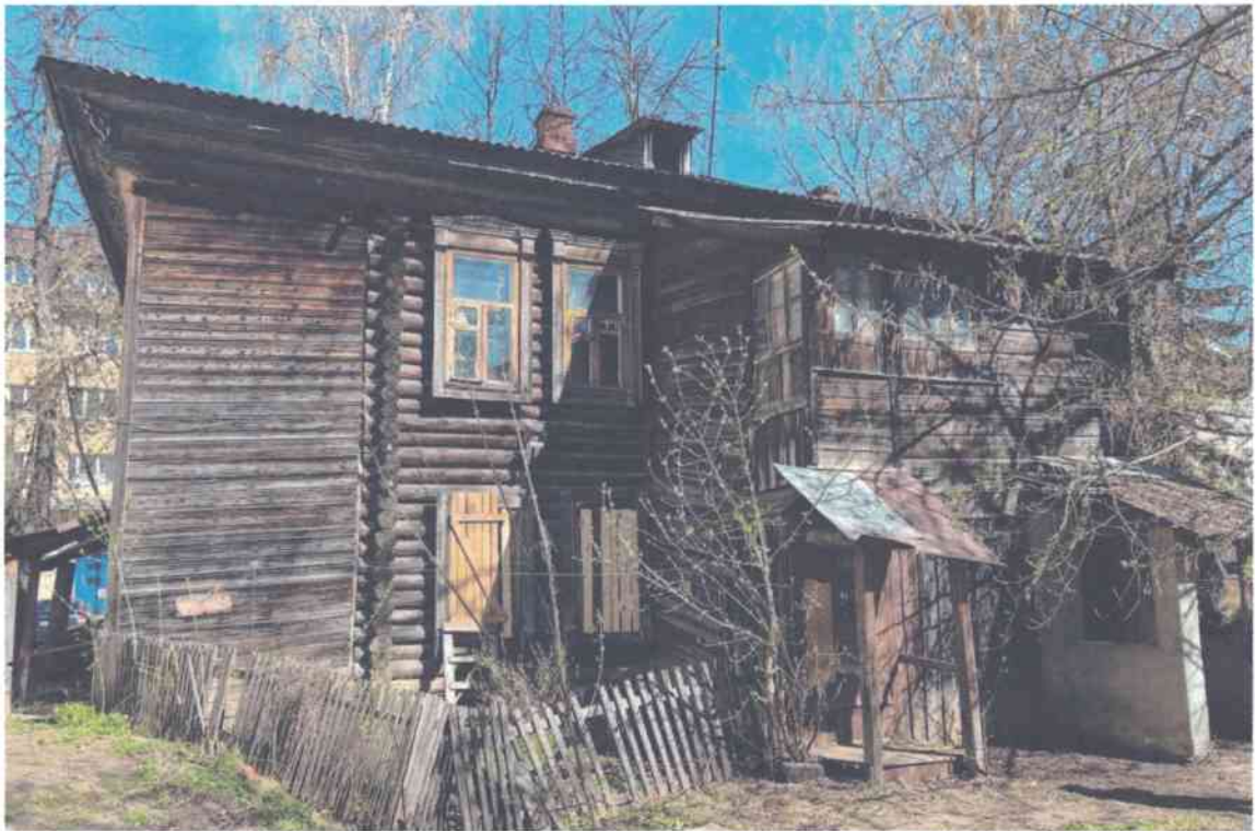
Фото 5. ОКН «Дом с деревянной резьбой». Вид на главный фасад с запада. В западной части фиксируются просадки и перекос стен северо-западного фасада, водосточные желоба, трубы и водосборные воронки утрачены, оконные переплеты, коробки и подоконные доски частично поражены гнилью и жучком, частично отсутствуют штапики, трещины стекол, остекление частично отсутствует.
