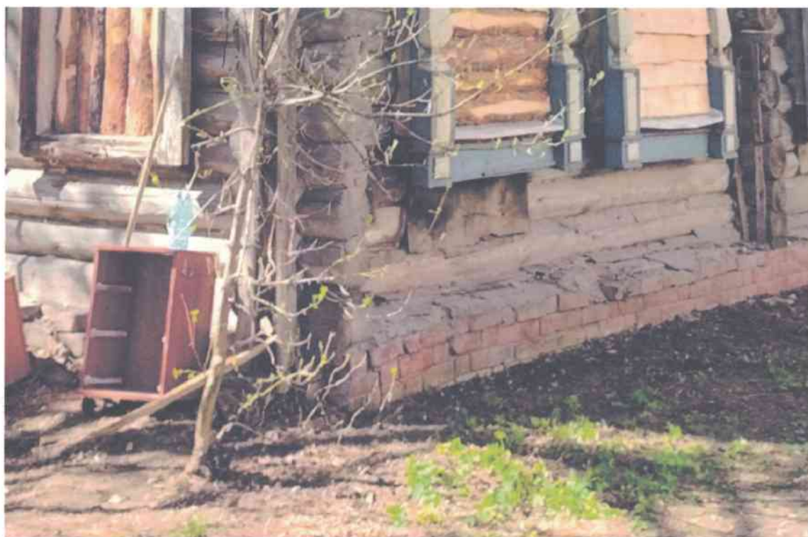
Фото 7. ОКН «Дом с деревянной резьбой». Фрагмент восточный угол объекта. Трещины кирпичной кладки цоколей, на локальных участках разрушение кирпичной кладки, роль отлива выполняла стяжка из цементного раствора -разрушена, отмостка отсутствует, следы увлажнения и загнивание древесины под оконными проемами, на локальных участках древесина нижней части наличников поражена гнилью, ослаблены крепления декоративных элементов; в непосредственной близости (на расстоянии менее 0,5 метров) от стен объекта растут деревья, корни которых могут стать причиной разрушения конструкций объекта.
