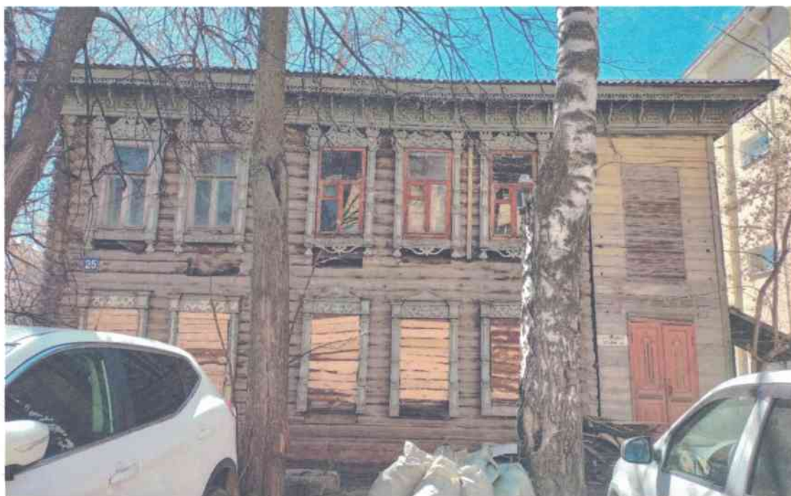
Фото 1. ОКН «Дом с деревянной резьбой». Вид на главный фасад с северо-востока. Отсутствует информационная надпись объекта культурного наследия, следы увлажнения и загнивание древесины в чашках соединения бревен, под оконными проемами, в карнизной части; водосточные желоба, трубы и водосборные воронки утрачены.
